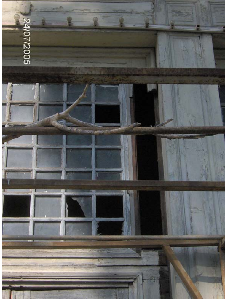
Şekil 4.49 Camlarda ve ahşap elemanlarda eksiklikler.
