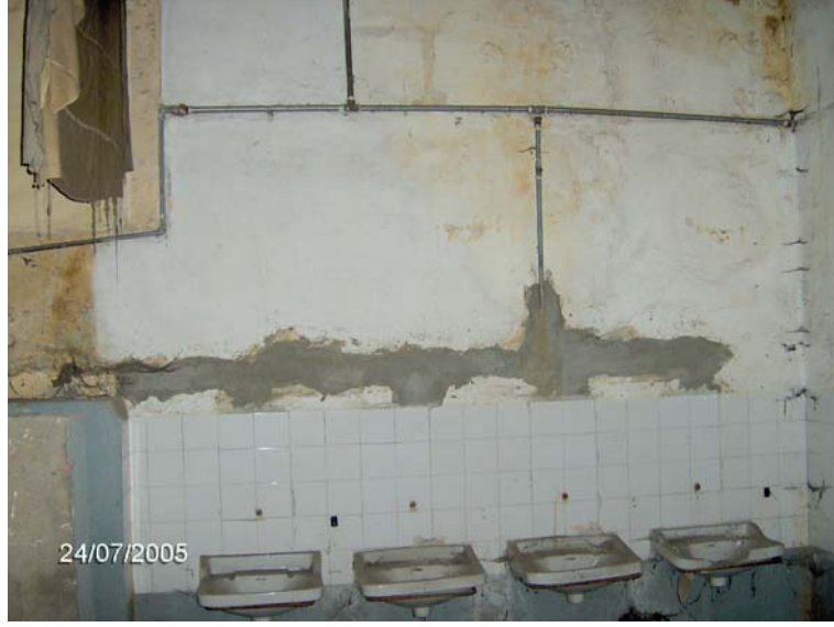
Şekil 4.55 Tesisat için duvarda oluşturulan yırtık harçla kapatılmış (Z05).
