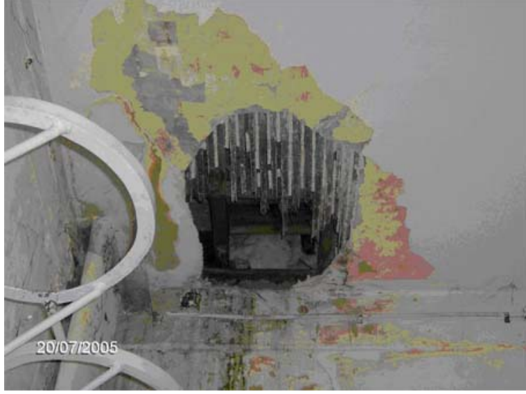
Şekil 4.124 Çatı strüktüründeki rutubetlenme ve parçalarda kopmalar.
