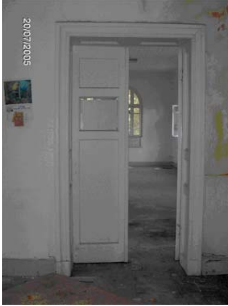
Şekil 4.129 Orijinal kapı kanatları değiştirilmiş.
