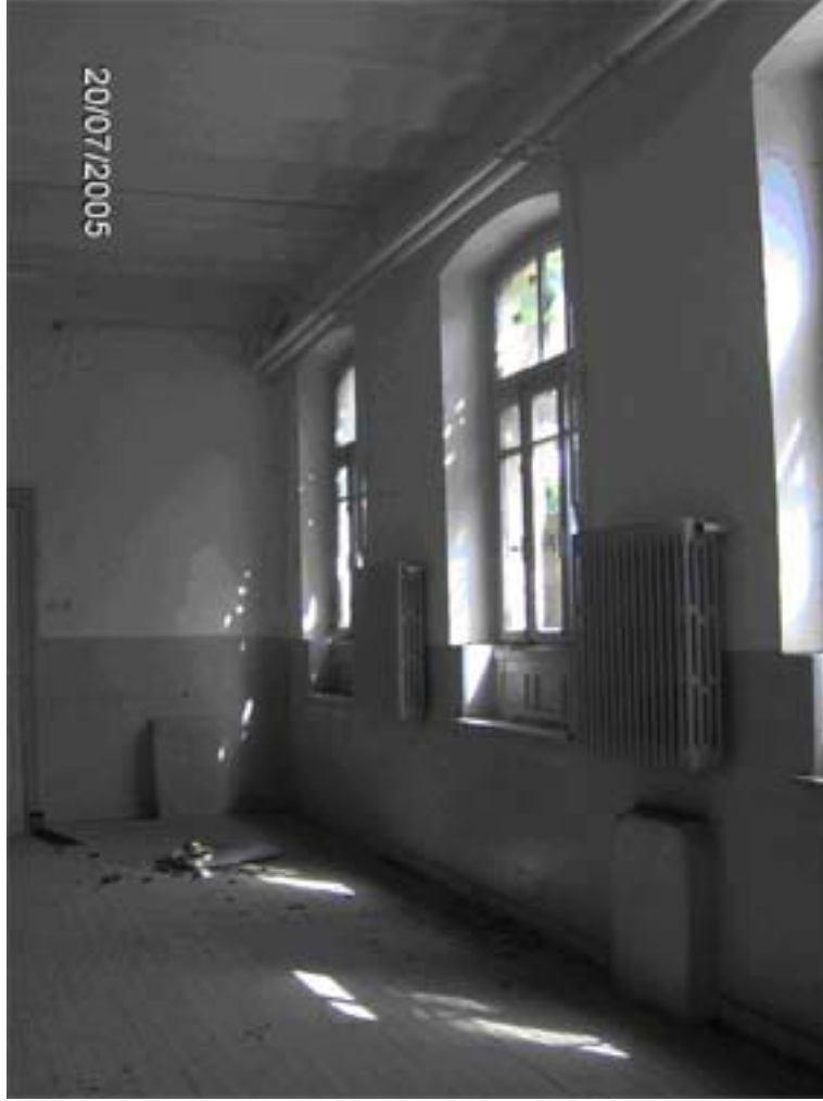
Şekil 4.132 Yapıya eklenen radyatörler ve tesisat boruları.
