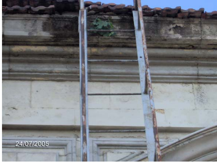
Şekil 4.42 Saçak altındaki taş silmede rutubetlenme.
