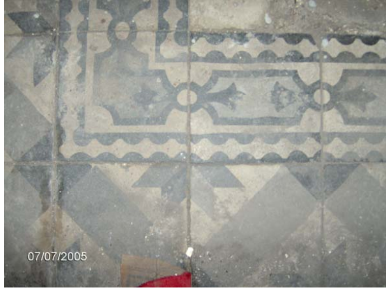
Şekil 4.80 Zemin kat giriş holündeki karo mozaik (Z01).
