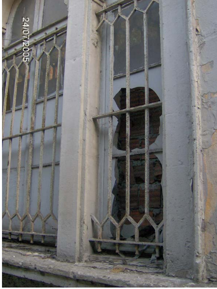
Şekil 4.45 Pencere camlarında kırılma ve parmaklıklarda paslanma.
