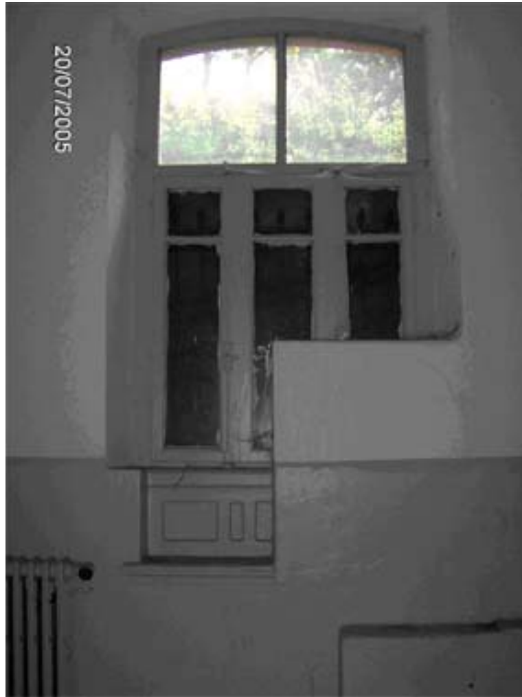
Şekil 4.118 Pencerenin önüne kısmi olarak duvar örülmüştür.
