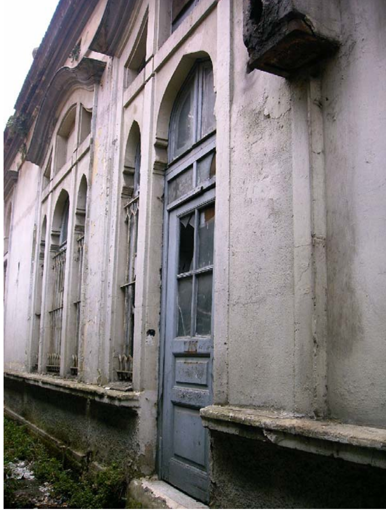
Şekil 4.39 Kuzeydođu cephesinde açılan kapı ve kapatılan pencere boşluğu.
