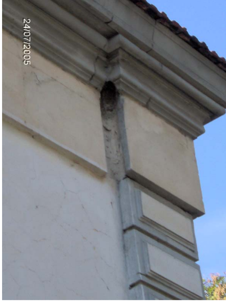
Şekil 4.57 Yağmur suyu iniş borularında kopmalar.
