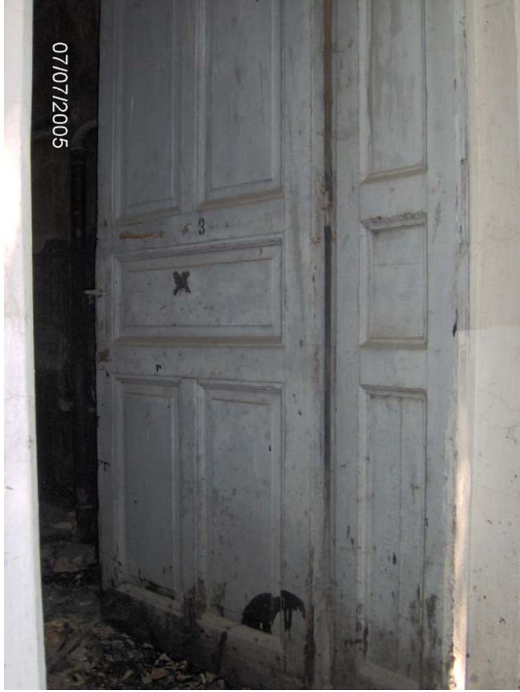
Şekil 4.66 Zemin kat ısıtma merkezi giriş kapısı (Z04).
