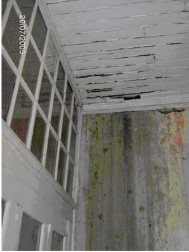
Şekil 4.133 Ahşap tavanda oluşan rutubetlenme ve açılma.
