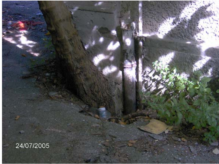
Şekil 4.38 Kuzeybatı cephesinde yapıya dayanan ağaç kökü.
