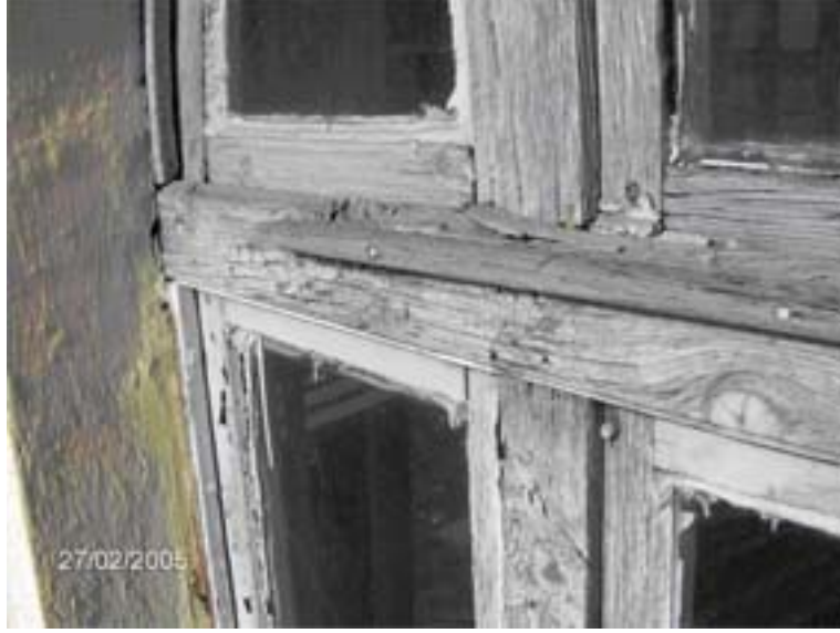
Şekil 4.128 Ahşap yüzeylerde görülen aşınma.
