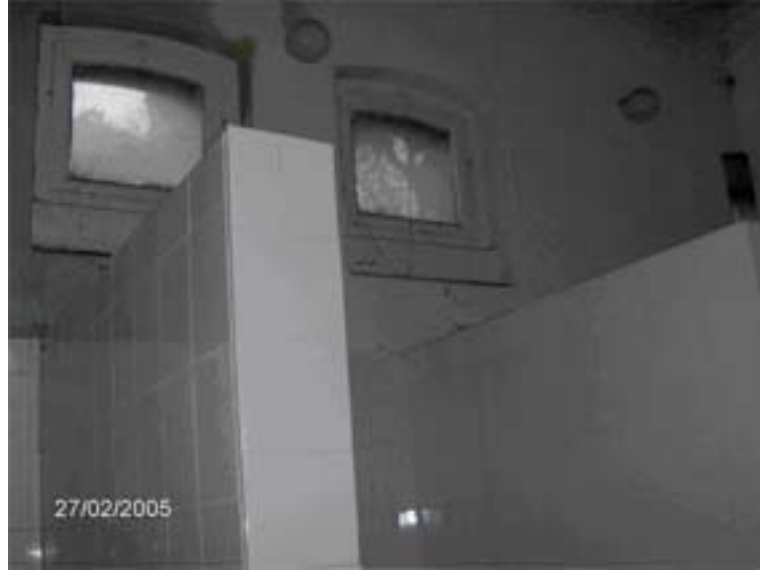
Şekil 4.121 Tuvalet ve duşların bulunduğu bölümde kapatılan pencereler (B04).
