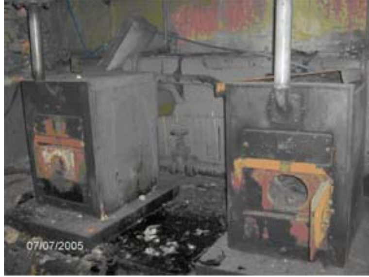
Şekil 4.119 Zemin kat ısıtma merkezi (Z04).
