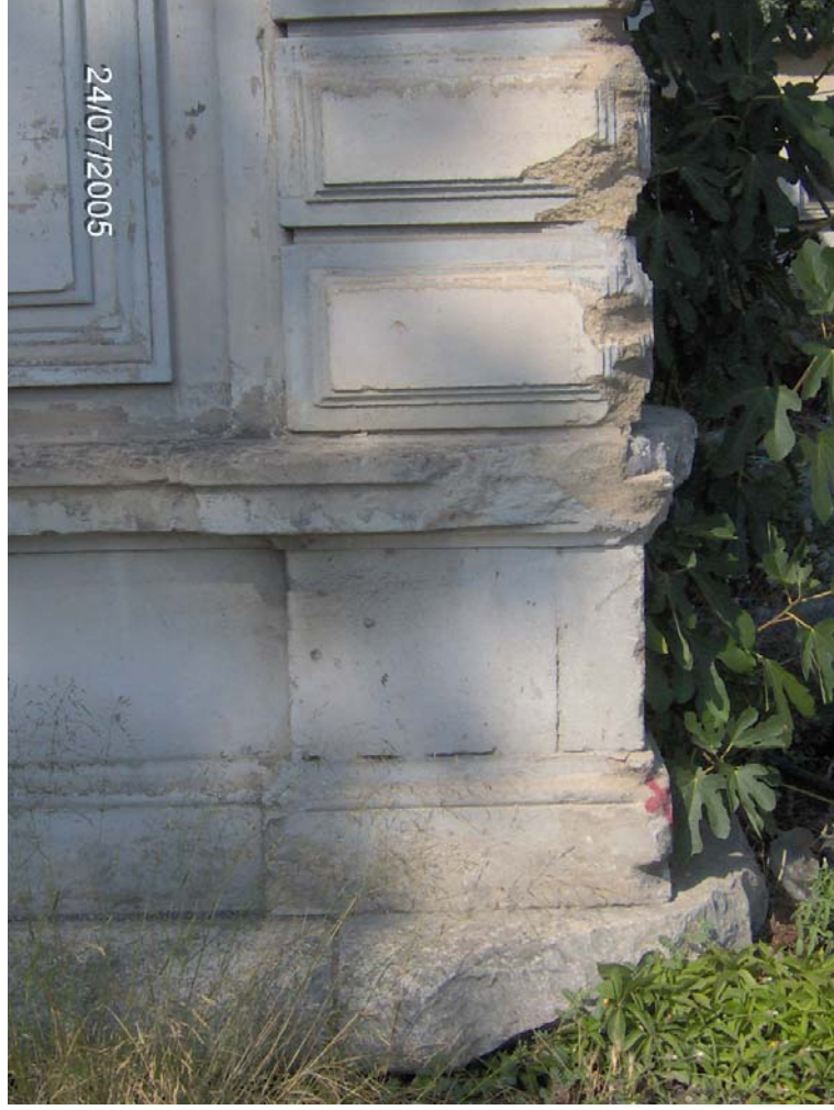
Şekil 4.44 Taş silmelerde ve köşelerdeki bosajlı taşlarda kopmalar.
