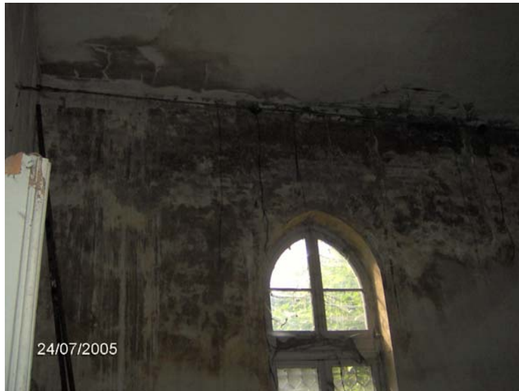
Şekil 4.54 Duvar yüzeyinde rutubetlenme (Z04).
