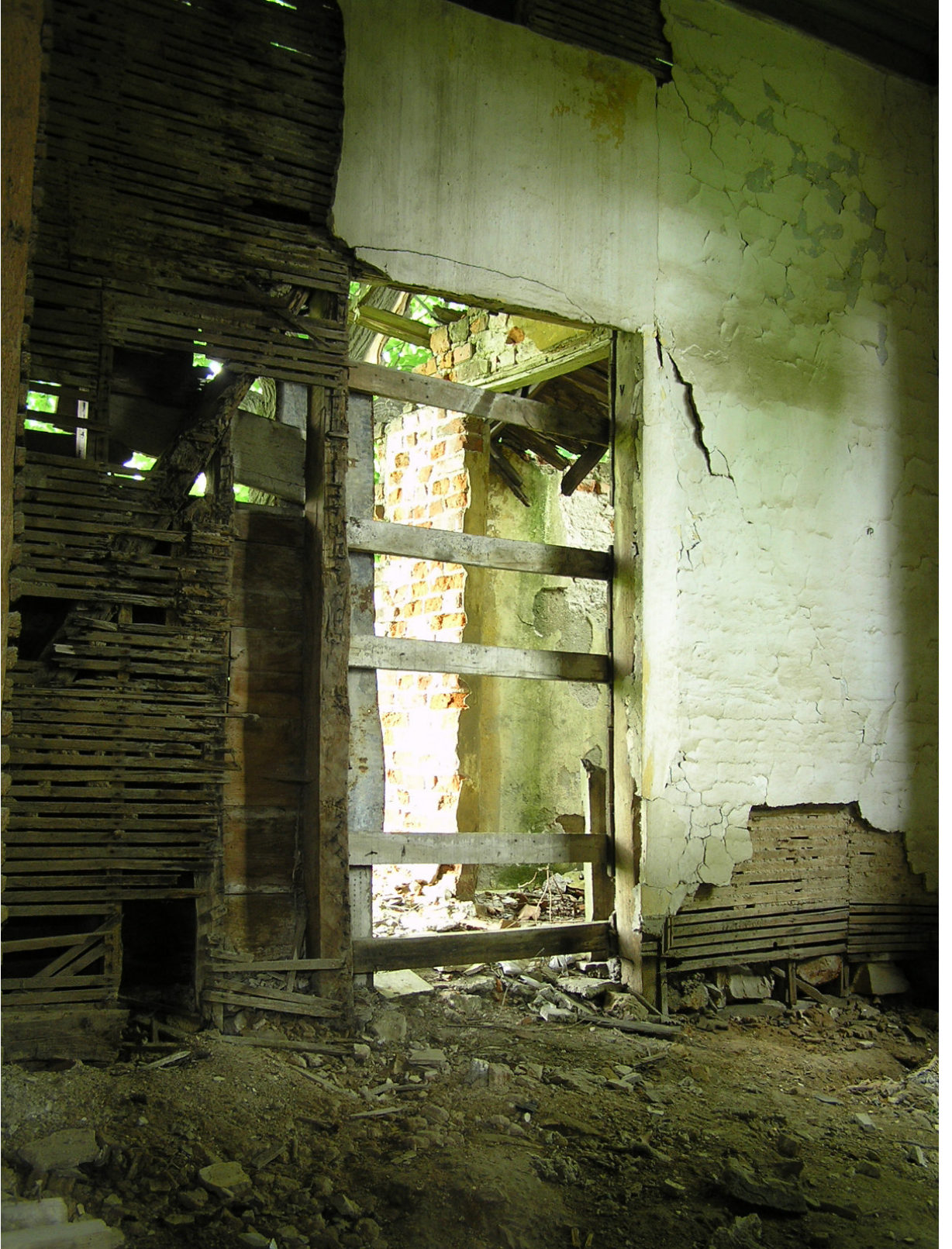
Resim 4.51 ZK07 no'lu odanın karkası bozulan duvarı
