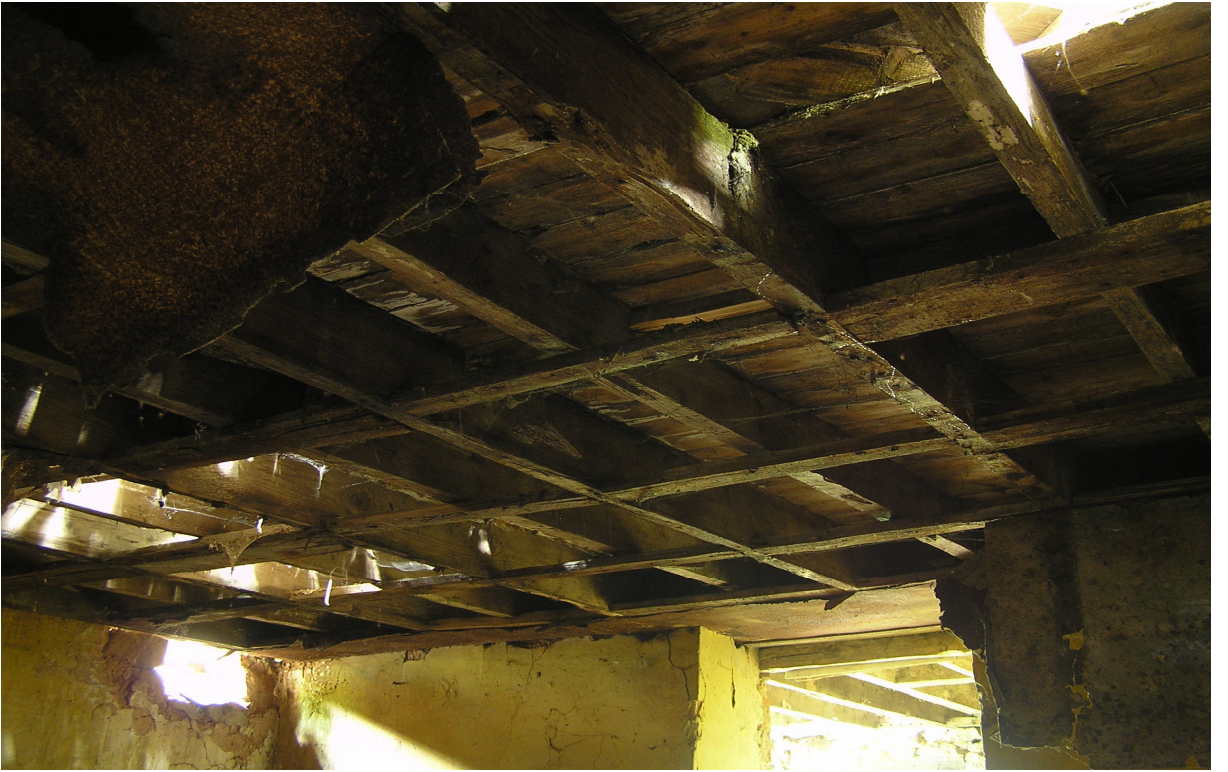
Resim 4.22 Bodrum kat ahşap tavan kaplamalarının durumu
