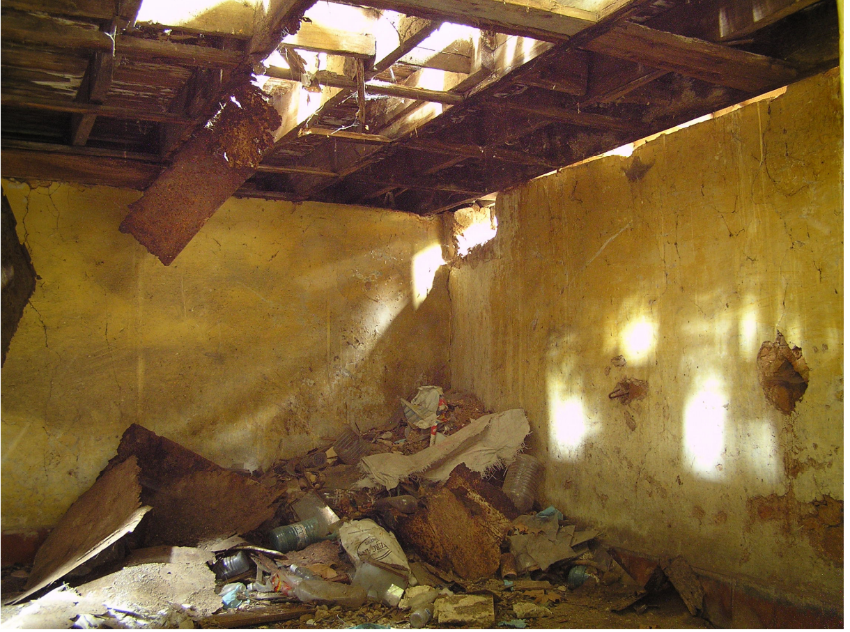
Resim 4.23 Bodrum kat ahşap tavan kaplamalarının durumu
