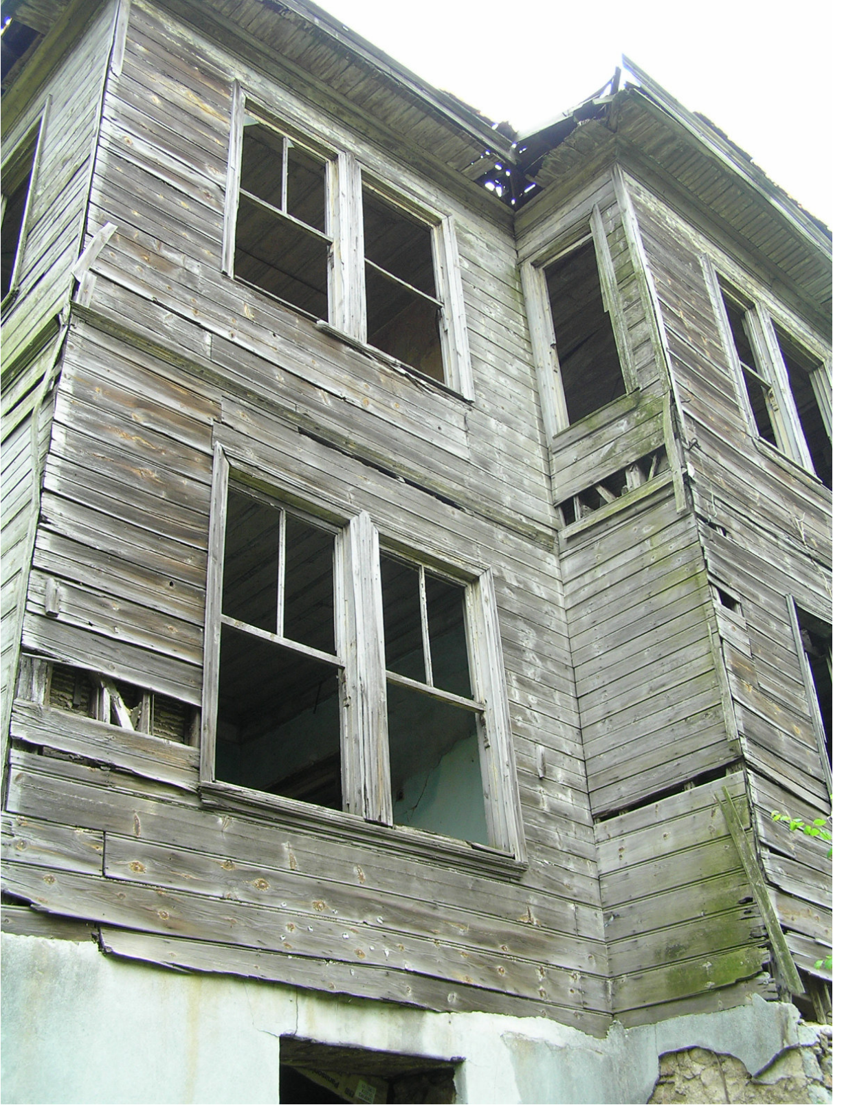
Resim 4.57 1K04'te giriş aksının sol yanına açılan pencere boşluğu
