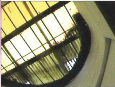
Resim 5 Merdiven ışığı için bırakılan kısımda metal korozyonu
