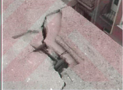
Resim 9 Teras katta kaçak kat çıkabilmek için parapete yerleştirilen I profillerin korozyonu sonucu parapet duvarını çatlatması.
