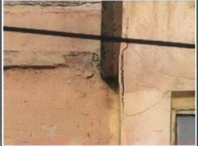
Resim 7 Arka cephe duvarında sıva çatlakları, parça kopmaları
