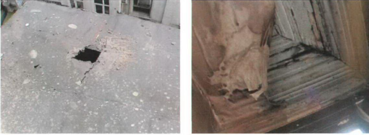
Şekil 4.18 162/30A binasında, 2. kattaki cumbanın çatı kaplama malzemesinin bozulması
