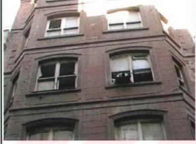
Resim 7 Ön cephede de bakımsızlıktan bazı katların camları kırılmış binaya su giriyor ve dış duvarda sıva dökülmeleri mevcut
