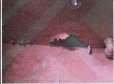
Resim 15 Katın maruz kaldığı uzun süreli rutubet ve nem tavan ve duvar sıvalarının bozulmasına neden olmuş
