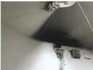
Resim 22 Çatıdan gelen nemin üçüncü kattaki elektrik kontagina kısa devre yaptırması sonucu yangın çıkması
