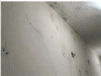
Resim 10 Birinci kattan sızan su bodrum birinci katında da bozulmalara neden olmuştur
