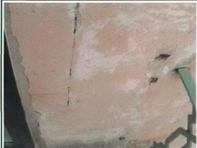
Resim 5 Arka cepheden sıva çatlaklı bozulması
