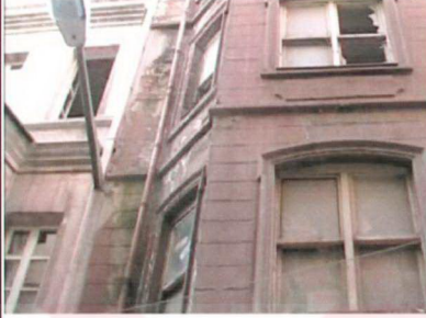
Resim 6 Arka cephede bakımsızlıktan bazı katların camları kırılmış binaya su giriyor, dış duvarda sıva dökülmeleri ve yosunlanmalar
