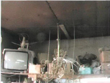
Resim 12 Binanın arka cephesi üçüncü katındaki çatıdan gelen nem ve rutubetin, tavan ve duvar kaplamalarının da meydana getirdiği bozulmalar
