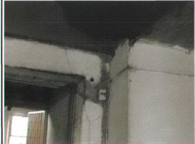
Resim 13 Binanın üçüncü katında ciddi rutubet ve nem problemi var. nem ve elektrik kontağı iç içe her an yangın çıkabilir
