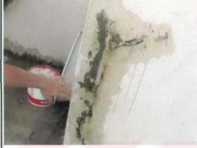
Resim 7 Çatı katı duvarında sıva çatlağı
