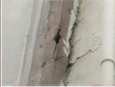
Resim 6 Dış cephe duvarında çatlak
