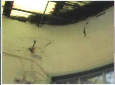
Resim 6 Merdiven ışığından giren su duvar sıvası çatlağına ve bozulmasına neden olmuş
