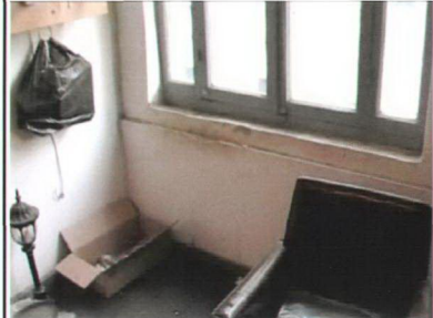
Resim 17 İkinci kat ön cephe duvarında nem
