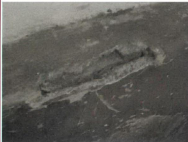
Resim 10 Merdiven boşluğu duvarında sıvadan parça kopması
