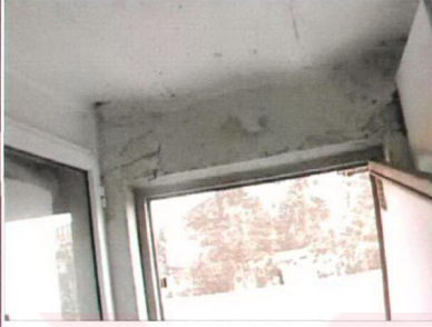
Resim 6 Çatıdan binaya giren su, çatı katı duvarlarında kısmi sıva malzeme bozulmalarına neden olmuştur
