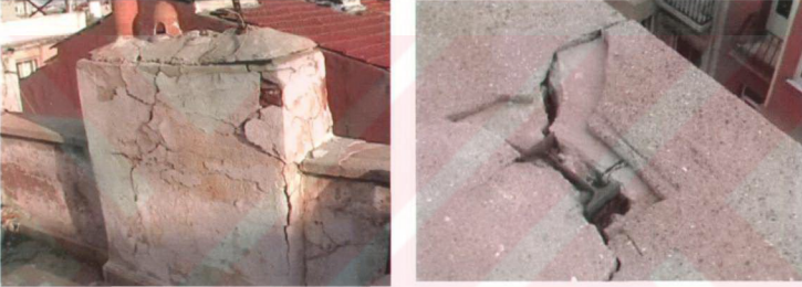
Şekil 4.19 281/9 binasının teras duvarında sıva çatlakları ve I profilin korozyona uğrayarak teras duvarını çatlatması
