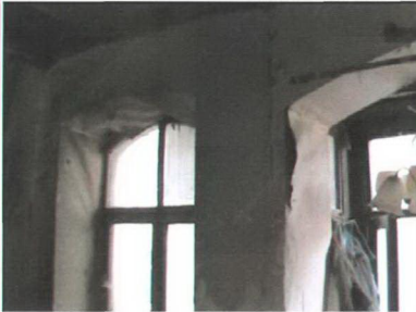
Resim 16 Tavanlar ve duvarlar kağıtları nemden kabarmış
