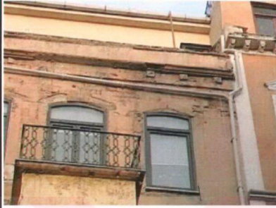
Resim 6 Ön cephede duvarında sıva dökülmeleri, parça kopmaları, malzeme bozulmaları
