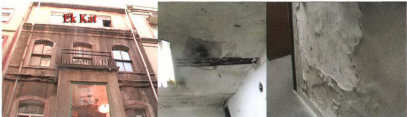
Şekil 4.17 Bina eklerinden kaynaklanan bozulmalar
