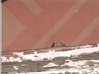
Resim 8 Teras katındaki duvarda sıva çatlağı ve nemden cephe kaplama tahtasında bozulma.
