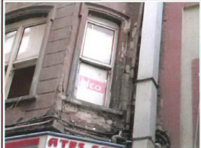
Resim 5 Arka cephede cephe sıvasında parça kopmaları
