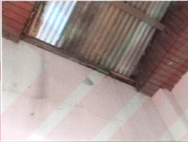
Resim 20 Merdiven ışığından binanın içine suyun girmesi
