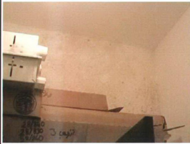
Resim 5 Zemin katta depo olarak kullanılan mekanda rutubet
