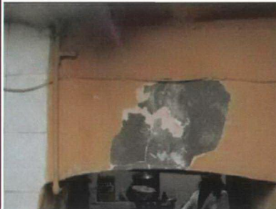
Resim 16 Tavanlar ve duvarlar kağıtları nemden kabarmış
