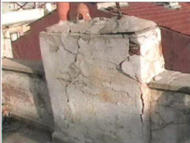
Resim 10 Baca ve parapet duvarında sıva ve parça kopması
