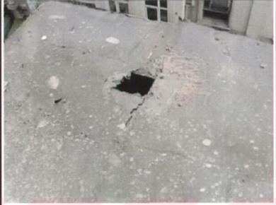
Resim 7 Ön Cephe cumbasının çatı kaplamasının bozulması sebebiyle cumbaya su giriyor
