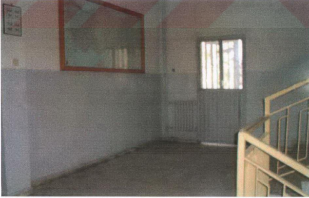
Şekil 4.17 Ana Merdiven Sahanlığındaki Yangın Kaçışı
