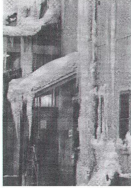
Şekil 3.11 Eğimli çatılarda kar sularının saçaklarda neden olduğu buzlanma (Tobiasson, 1994)
