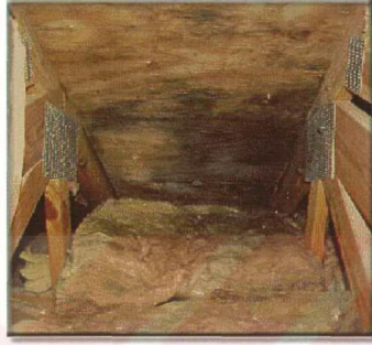
Şekil 3.9 Nemlenme sonucunda parçalanmış çatı yalıtımı [8]
