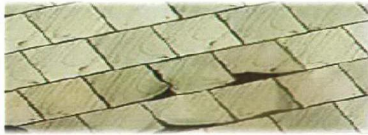
Şekil 3.15 Kaplama örtülerinde görülen bozulma ve renk değişimleri [9].
