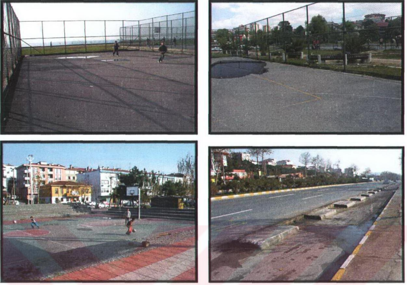
Şekil 3.4 Spor alanlarında kaplamadaki bozulmalar
