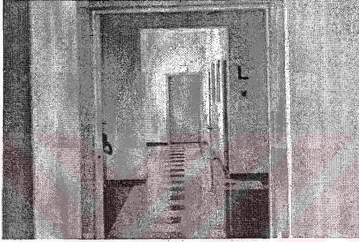
Şekil 5.11 Mevcut iç merdivenin çevre duvarındaki korunumsuz açıklık
