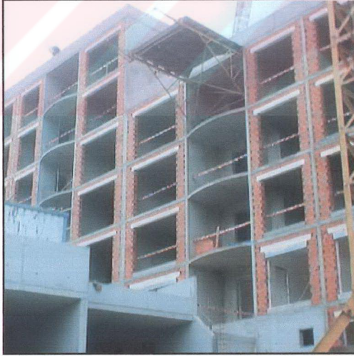
Şekil 3.1 Tünel kalıp sistemiyle üretilen Mesa Yamaçevler' de perde olmayan duvarlarda tuğla uygulaması
