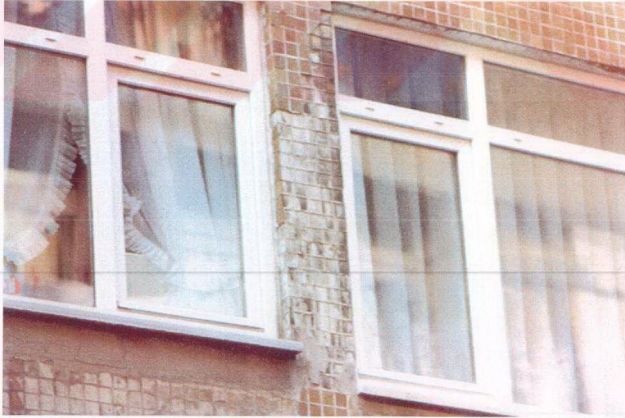
Şekil 4.8 Gre mozaik plarlarda ısı genişmesi nedeniyle oluşan dökölmeler
