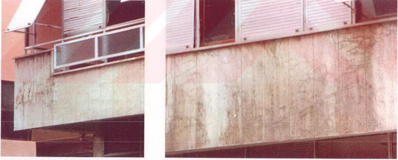
Şekil 4.14 Traverten plak yüzeyinde oluşan çiçeklenmeler
