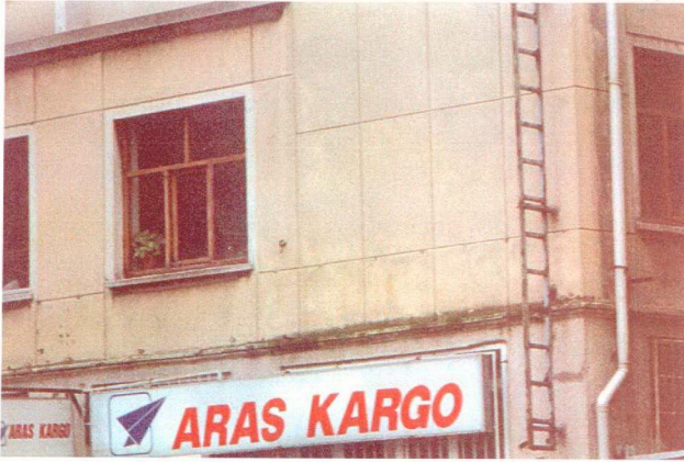
Şekil 4.19 Beton plakta oluşan yosunlaşmalar
