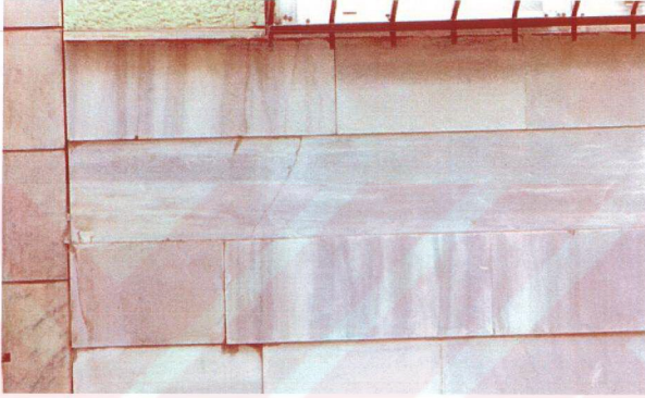
Şekil 4.9 Mermer kaplamada farklı ısı genişmeleri sonucunda oluşan çatlaklar ve kabarmalar
