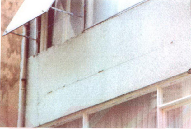
Şekil 4.20 Gre mozaik kaplamada, yapının taşıyıcı sisteminde meydana gelen hareketlerden ve malzemelerin farklı çalışmasından dolayı oluşan çatlaklar
