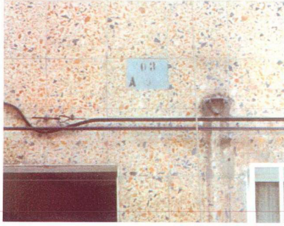
Şekil 4.5 Yapay taş kaplı beton üzerine takılan metal parça nedeni ile oluşan pas lekelenmesi
