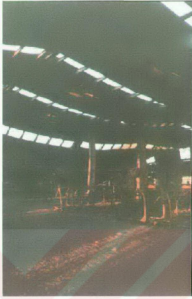
Şekil 4.12 Montel fabrikasının yangından sonra iç kısımdan görünüşü.
