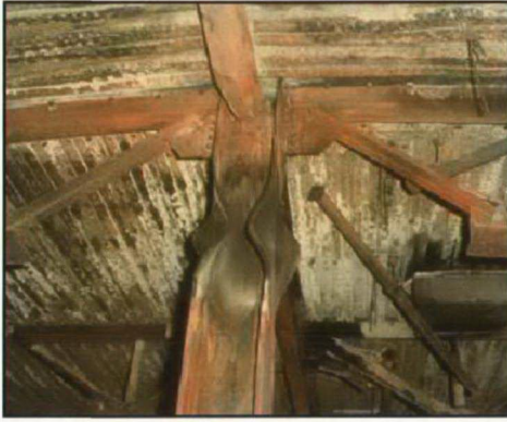
Şekil 4.7 Broadgate yangınında hasar gören yapının kolonlarındaki deformasyon (Smith, 1992).
