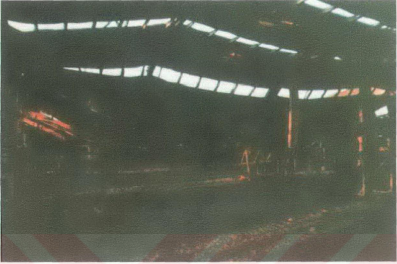
Şekil 4.14 Montel fabrikasının yangından sonra iç kısımdan görünüşü
