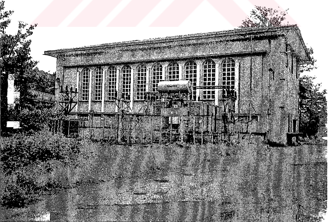
Resim 5.40 11 nolu trafo merkezi.
