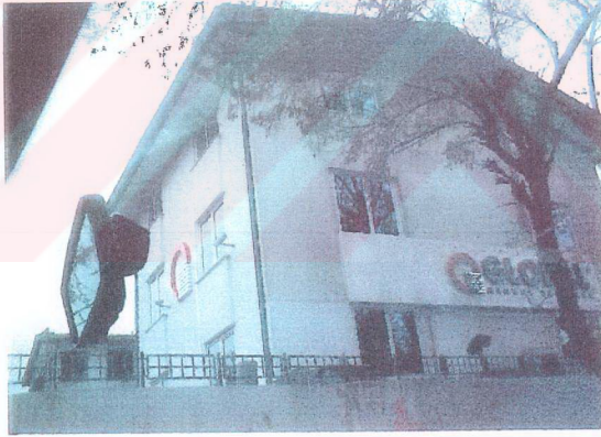
Şekil 3.48 İşyeri dönüşümü sonucu dış cepheye yerleştirilerek dokuyu bozan panolar
