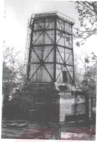
Şekil 5.57 Su soğutma kulesi, (Özel çekim)
