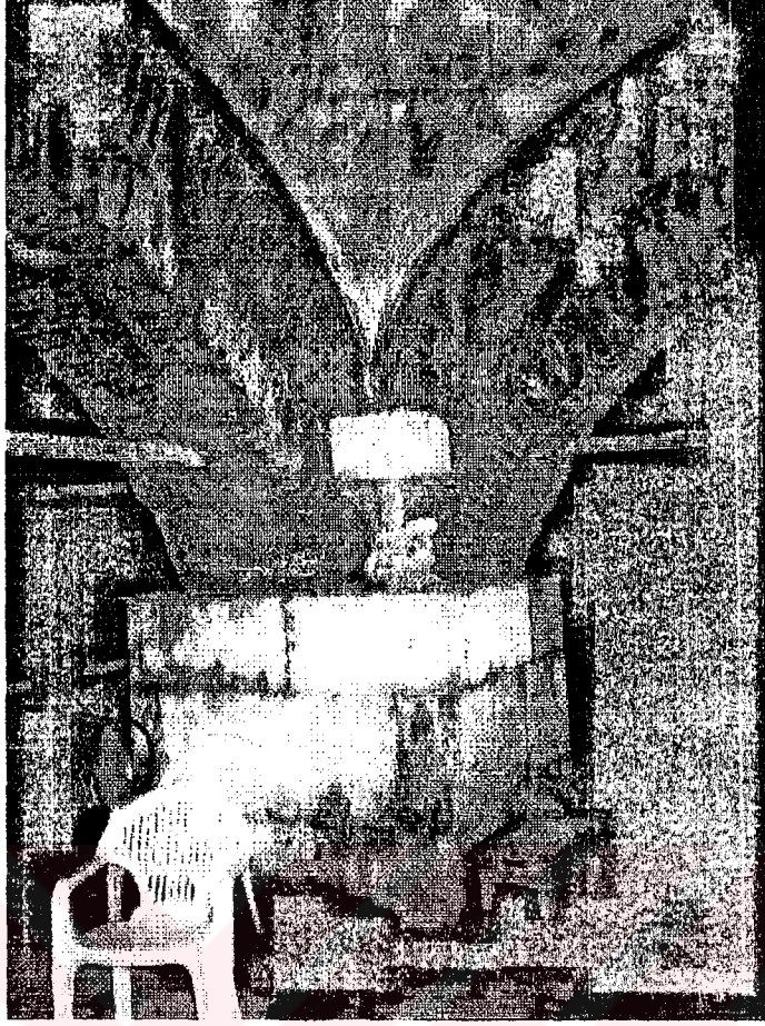
Resim 3.7 S1 Ayağı Güney ve Batı Cephesi Ve Çift Kat Kemerlerin Durumu
