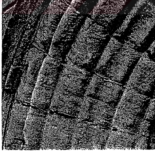
Foto2.2 Bağlayıcısı Kalsiyum Sülfat Olan Kum Taşında Asit Yağmuru Etkisiyle Bozulma
