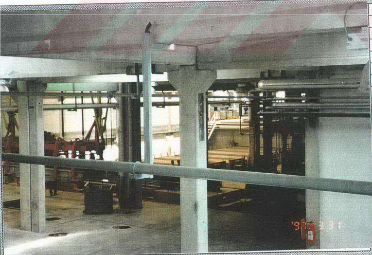
Çimentoş -Gazbeton Kırkkale Tesisi
