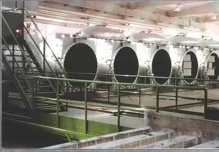
Çimentaş -Gazbeton Kırkkale Tesisi
