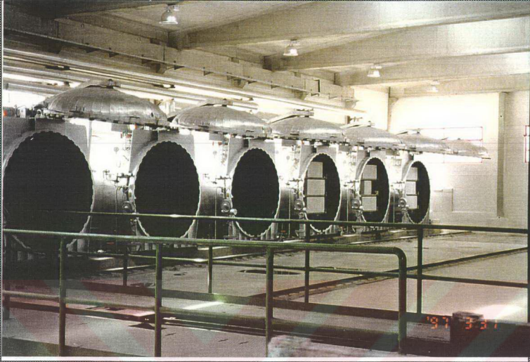
Çimentaş -Gazbeton Kırkkale Tesisi
