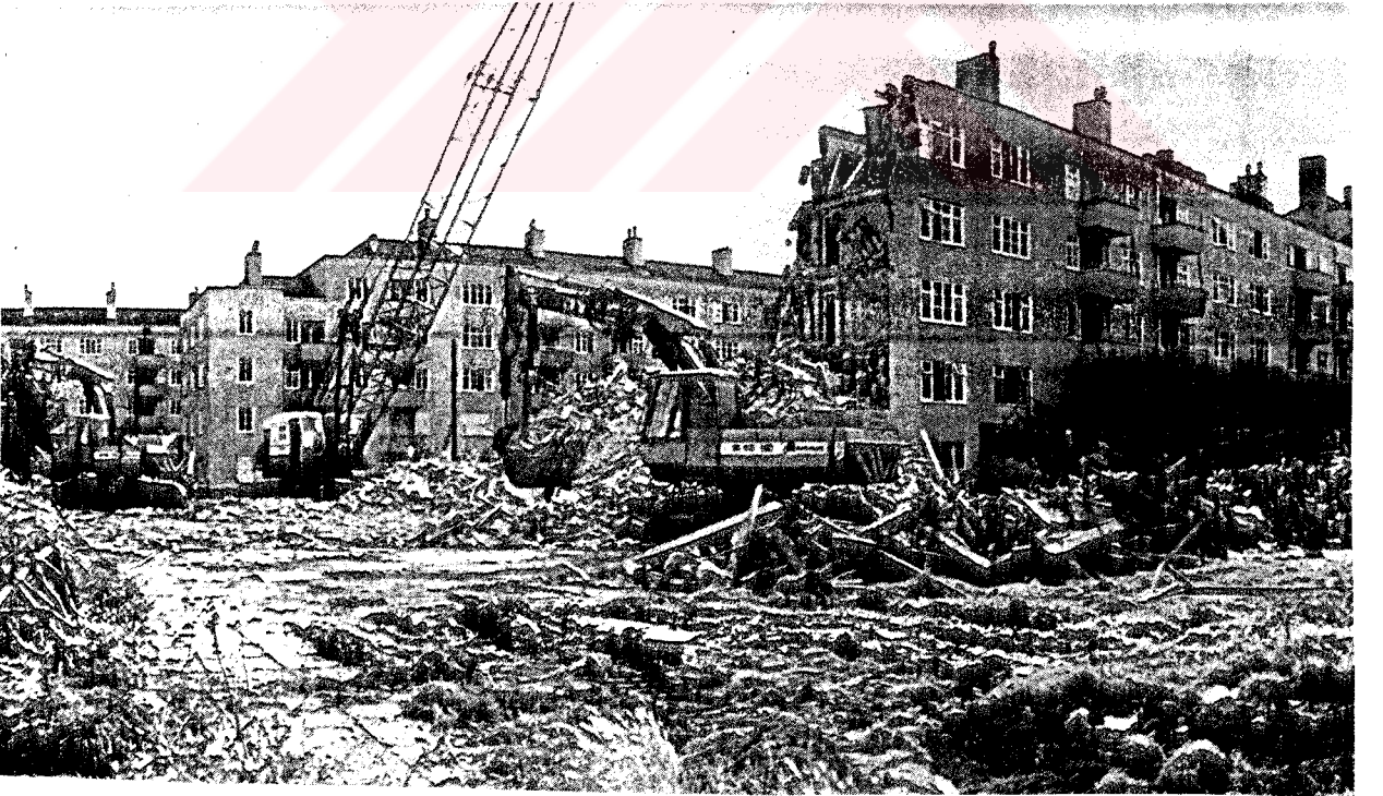
Şekil 44. Yıkılmadan önce ve yıkılırken St. Martin apartmanları
