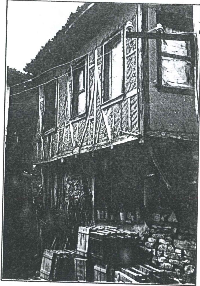
Resim 99. Zemin katta ihtiyaçtan dolayı cepheye sonradan açılan pencere (Env. no:34,237).
