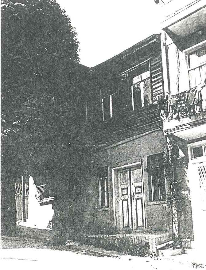
RESİM 47- Şirin sokak'ta 108 no.lu adada bulunan 8 no.lu ahşap ev (Kapı- kanat bölümlenme- si örneği)
