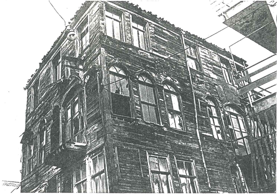
RESİM 54- Boyacıköy Çeşme Sokakta 5 no.lu ev (Bölgede strüktürü bozulmuş onarım bekleyen ev)
