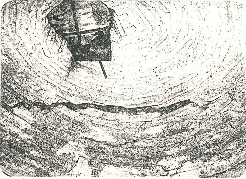
Resim 46- Kubbeden görünen bir çatlak.
