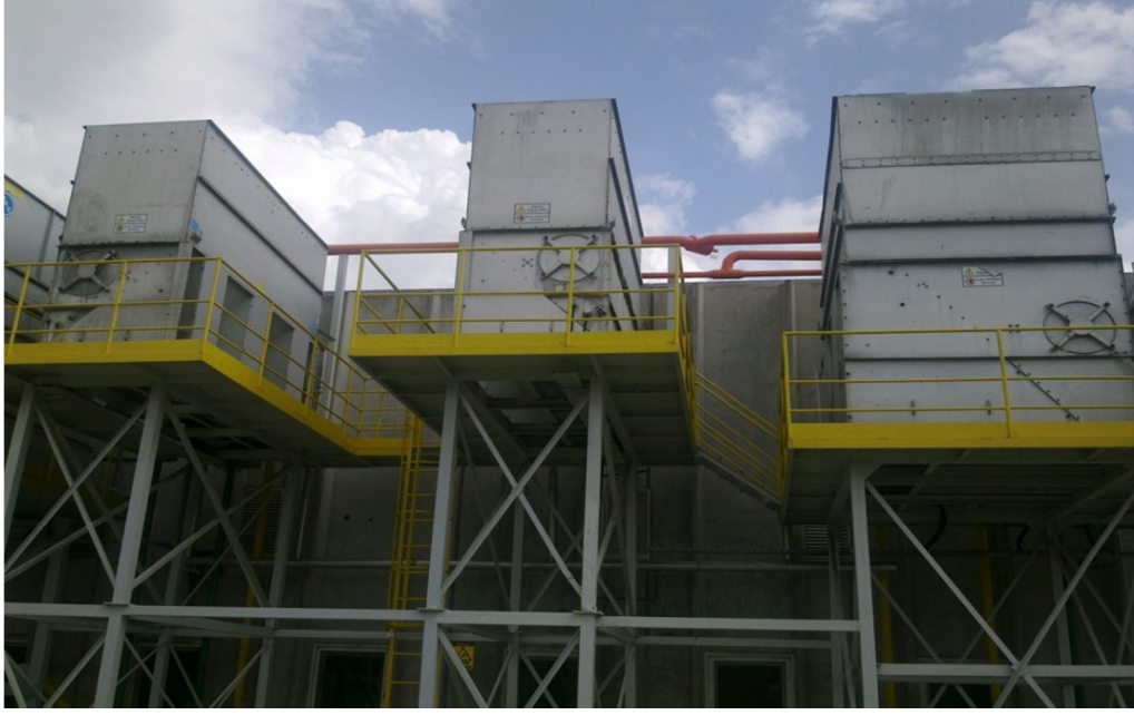
Şekil 4.7 Tesiste yer alan beş kondenserden üçünün yer aldığı fotoğraf
