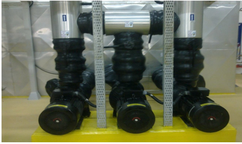
Şekil 4.10 Evaporatörlere giden hattaki pompaların fotoğrafı
