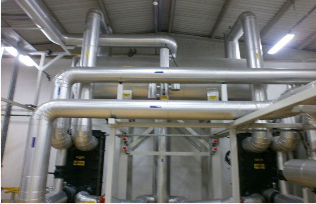
Şekil 4.14 İki evaporatörün üstünde yer alan ayırıcı tankın fotoğrafı
