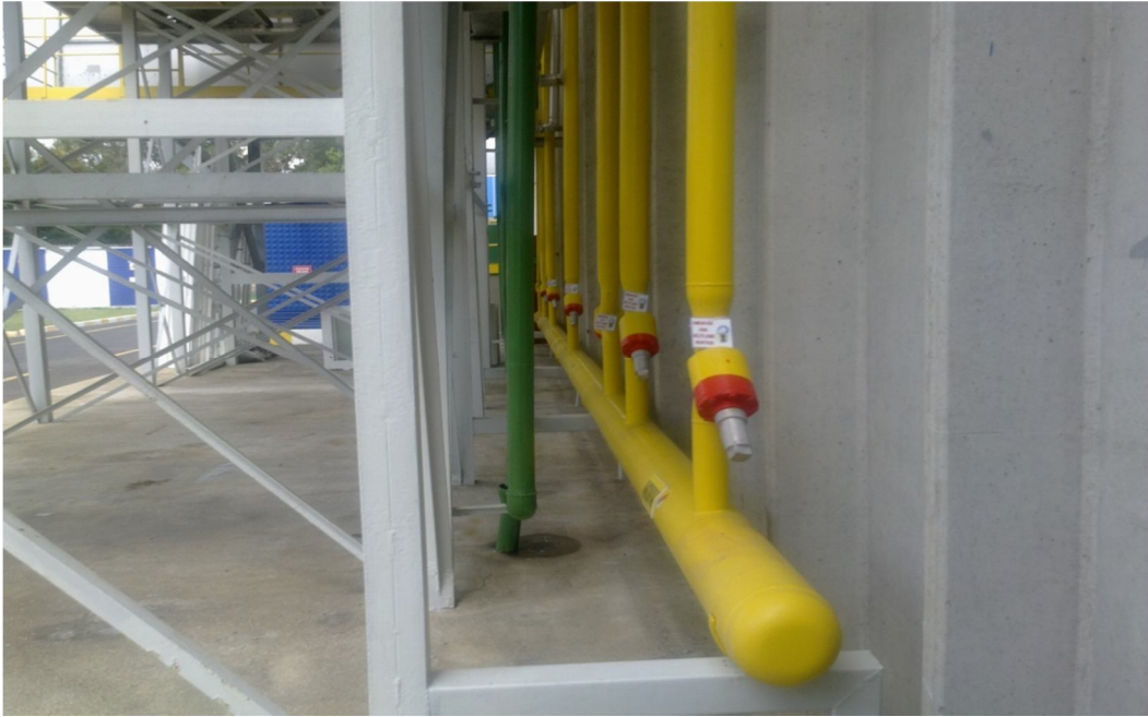
Şekil 4.16 Kondenserlerden sıvı tankına giden hattın fotoğrafı
