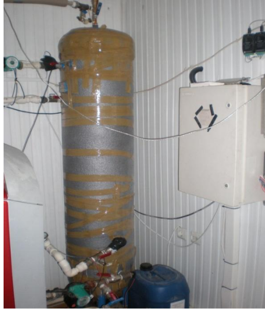
Şekil 5.12 Sistemde kullanılan akümülatör tankına ait görünüm
