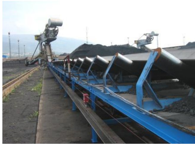
Şekil 0.3 Siloya kömür taşıyan konveyör bant [11].
