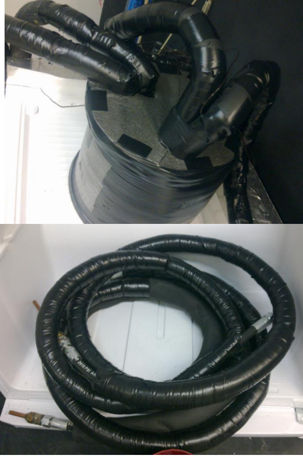
Şekil 3. 6 Yalıtımlı borular ve evaporatör haznesi. b- Chiller'in taşıdığı antifriz-su karışımını taşıyan yalıtımlı esnek plastik borular
