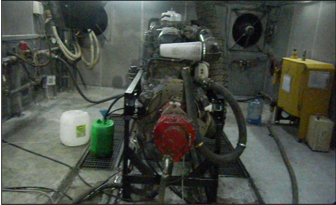
Şekil 2.3 Motor test odası görüntüsü
