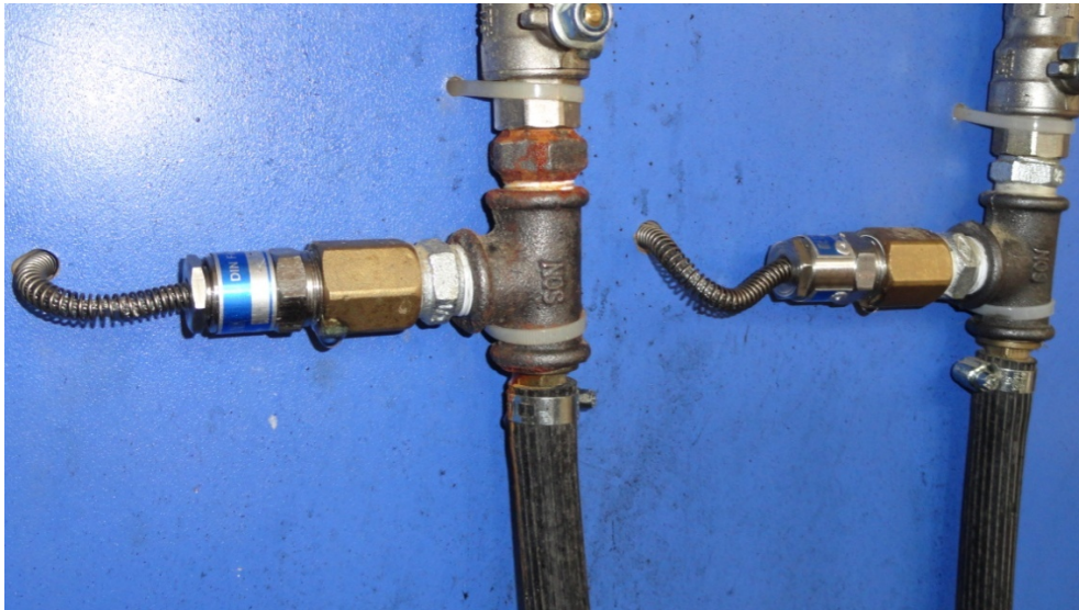
Şekil 4.14 Soğutma suyu giriş ve çıkış hatlarında konumlandırılmış termokupllar
