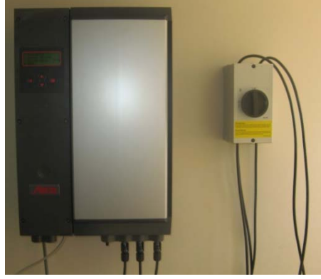
Şekil 6.4: Arçelik-LG işletmesindeki PV sistemde kullanılan inverter
