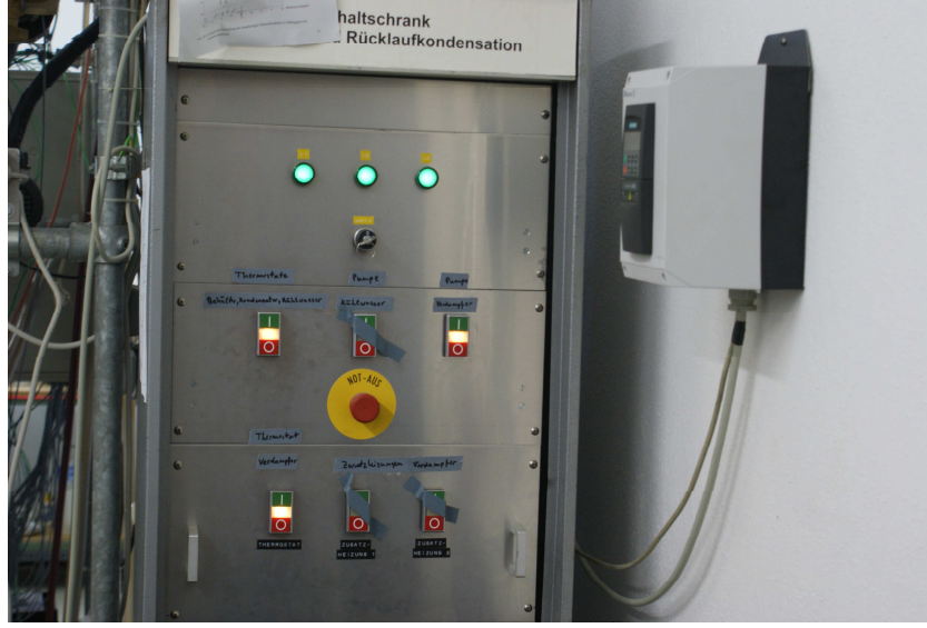
Şekil 4.5 Deneş tesisatının ana güç paneli
