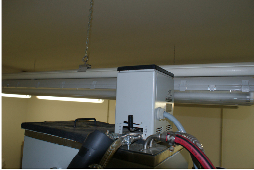
Şekil 4.16 Soğutma suyu kontrolü
