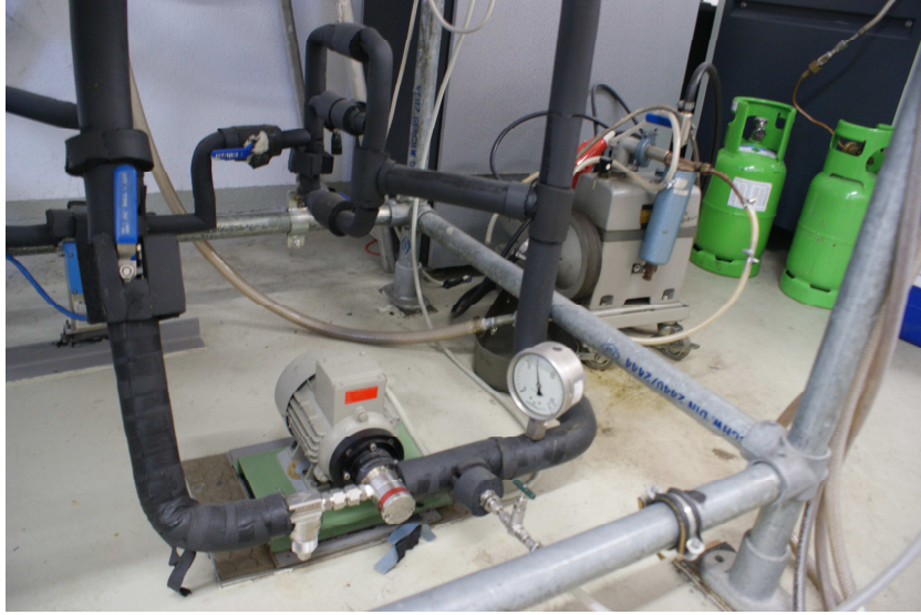
Şekil 4.11 R134a pompası (P1)
