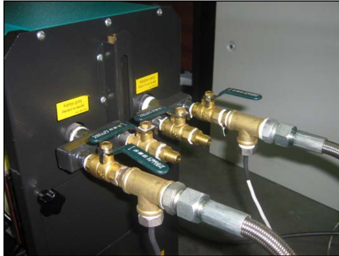
Şekil 5.11 Kalıp şartlandırıcının giriş ve çıkışına bağlanan termokupullar
