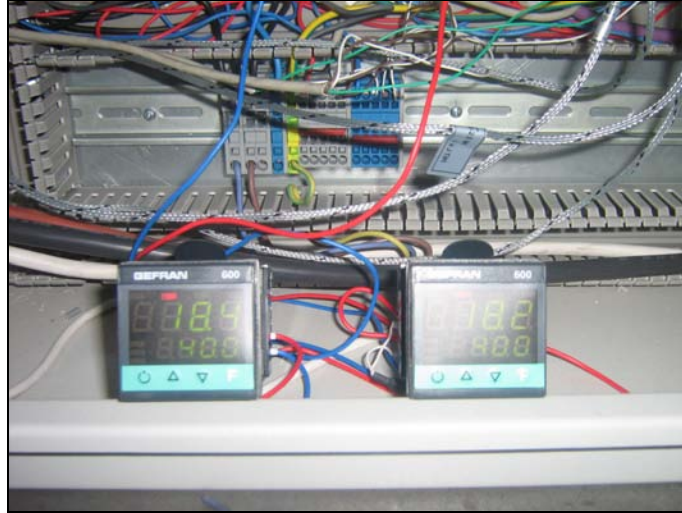
Şekil 5.12 Yağ giriş-çıkış sıcaklıklarının okunduğu göstergeler
