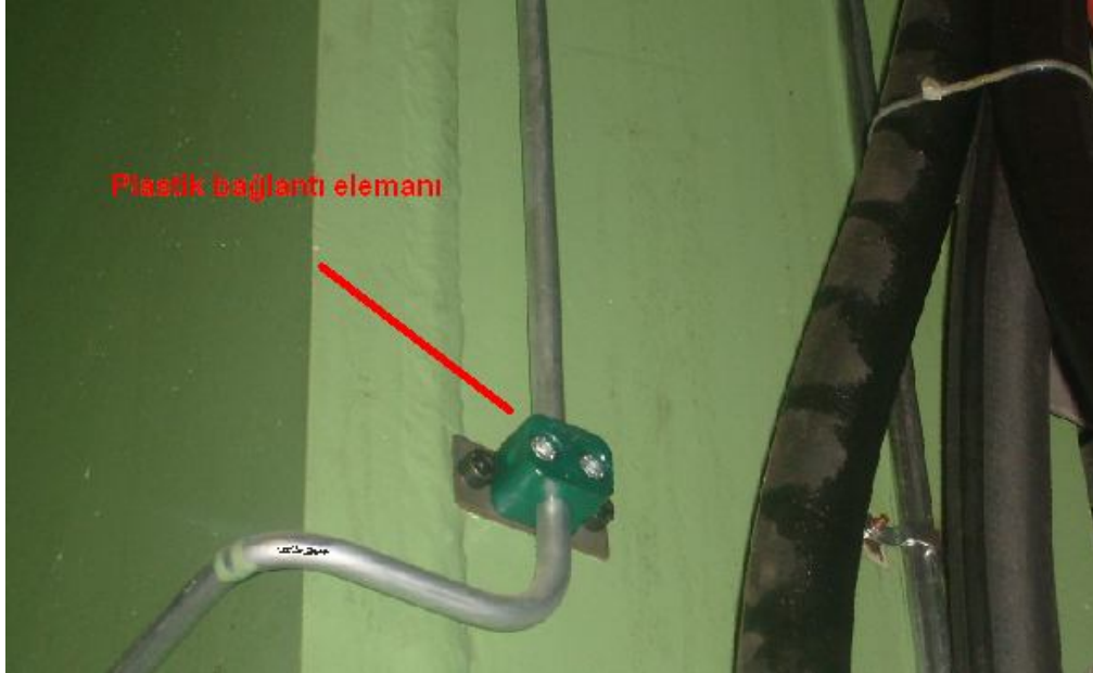
Şekil 4.20 Hidrolik ünitelerdeki plastik bağlantı elemanları
