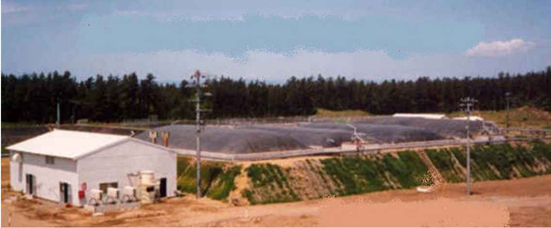
Şekil 6.18 Tam karışımli anaerobik arıtma tesislerinden görüntüler (Öztürk M. 2005)
