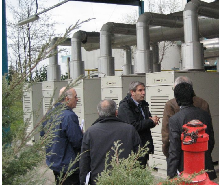
Şekil 3.1 Capstone C65 mikrotürbinli kojenerasyon tesisi (Fritolay, Kocaeli)
