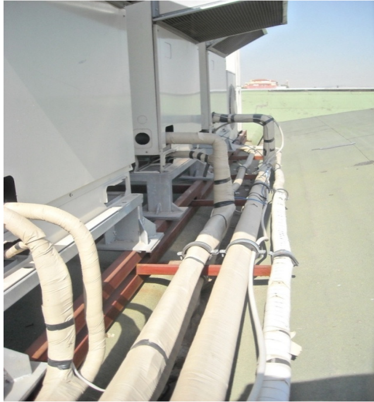
Şekil 3.5 Ataşehir ofiste kullanılan dış ünitelerin bakır boru (izolasyonlu) girişleri
