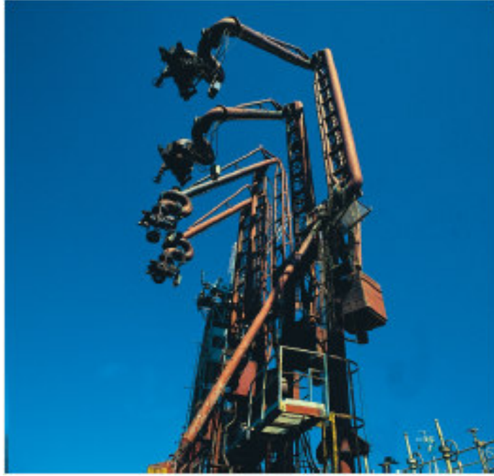
Şekil 2.5 Marmara Ereğlisi LNG terminali boşaltma kolları.
