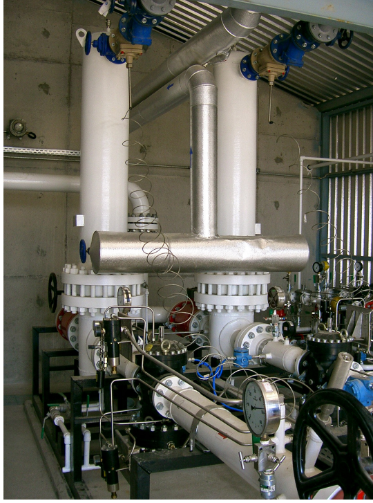
Şekil 3.9 RM-A istasyonu eşanjör ve sıcak su hatları.
