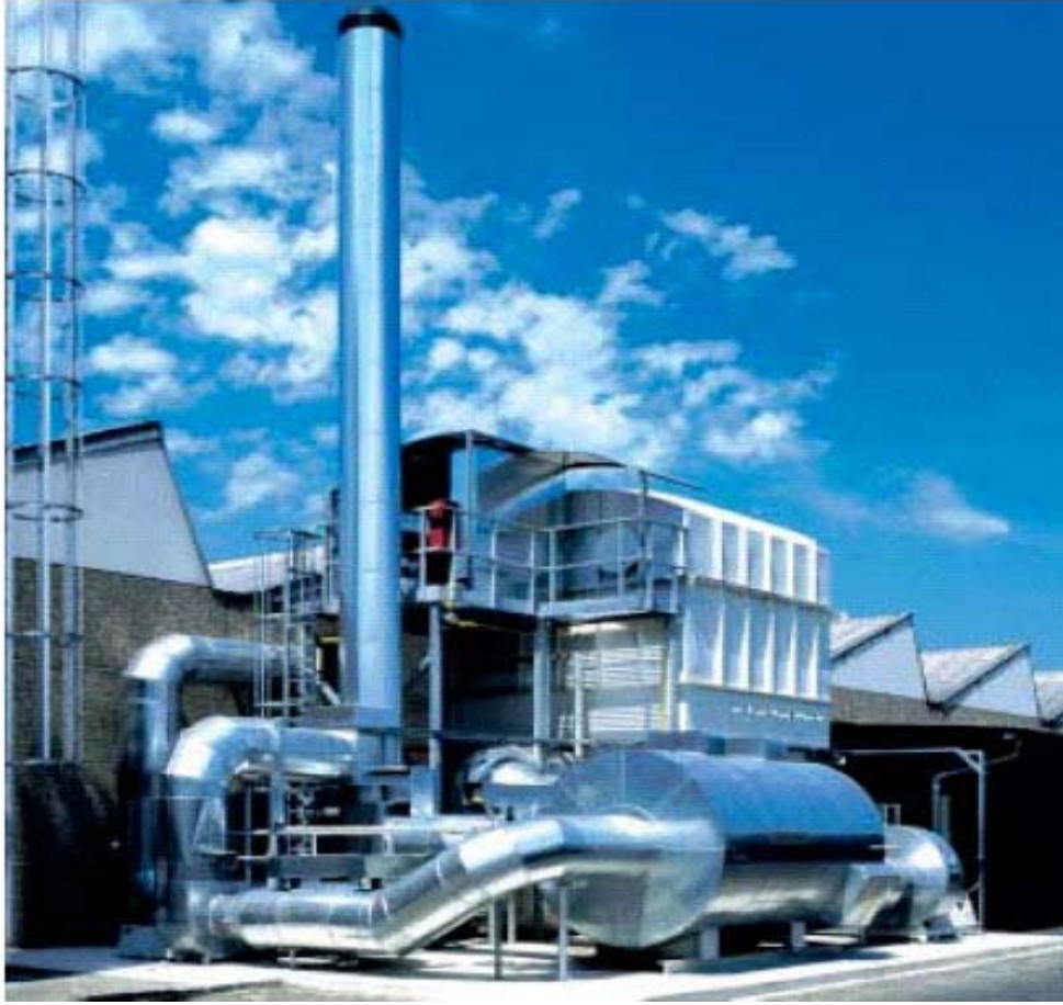
Şekil 4.9 Boya kurutma fırını baca gazlarını yakmada kullanılan termal insineratör cihazının tüm üniteleriyle birlikte dış ortama yerleştirildiği bir uygulama
