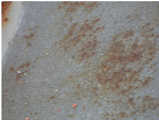
Şekil 6.27 Kış üstü güvertede korozyon
