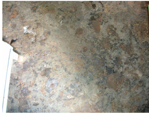
Şekil 6.25 Telsiz kamarası taban sacında korozyon
