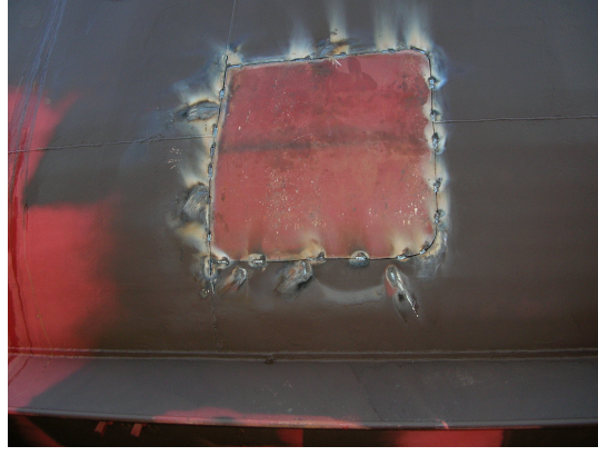
Şekil 6.12 Kalınlığı limit değerinin altına düşen sacın kesilerek yenilenmesi
