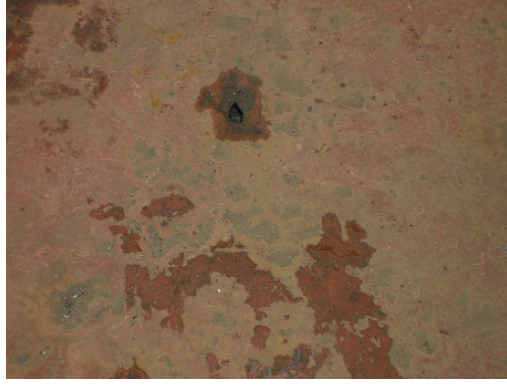
Şekil 6.24 Baş üstü güvertede korozyonlu bölge
