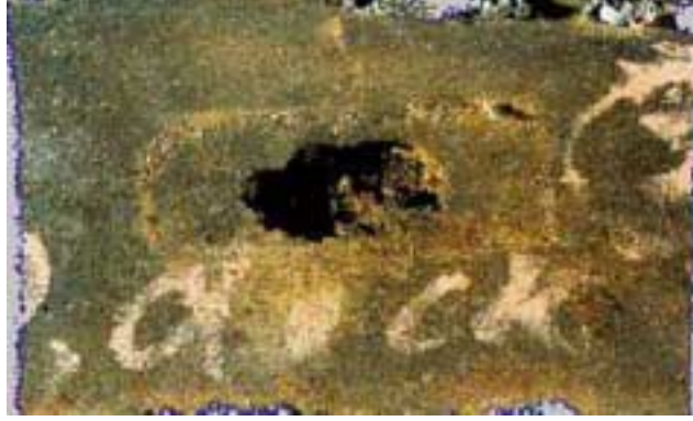
Şekil 5.8 Bakterilerden kaynaklanan korozyon (Byers, 1994).
